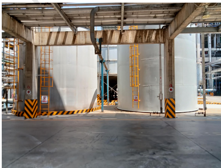
图 2.4-5 项目北侧渣水处理装置
