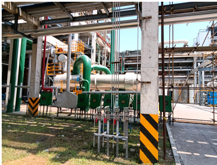
图 2.4-3 项目西侧渣水处理装置
