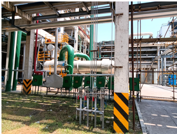
项目西侧渣水处理装置
