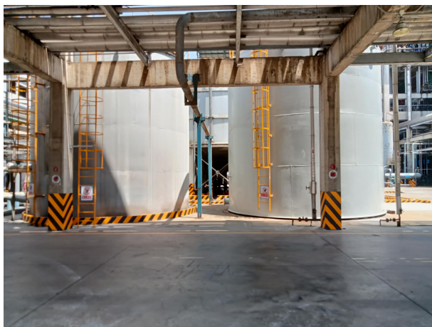
项目北侧渣水处理装置
