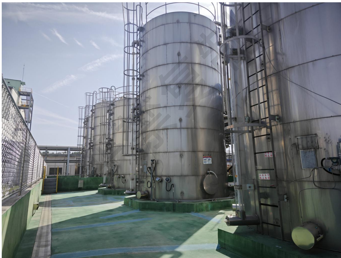
Cu 蚀刻剂罐区
