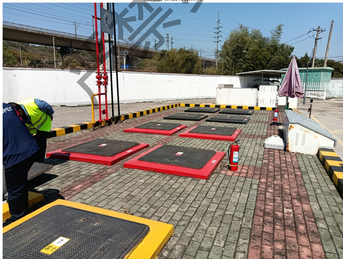
加油站罐区照片
