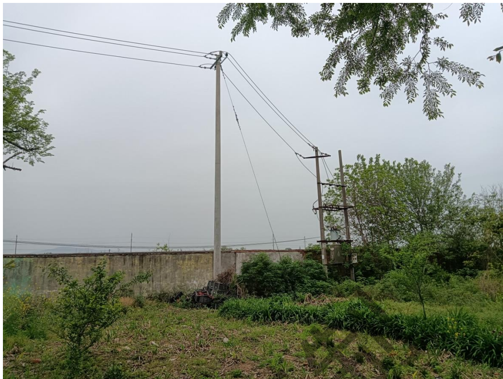
图 2-8 加油站西侧为架空电力线路和杆式变压器
