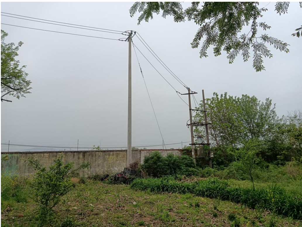
图 6 项目西侧架空电力线路
