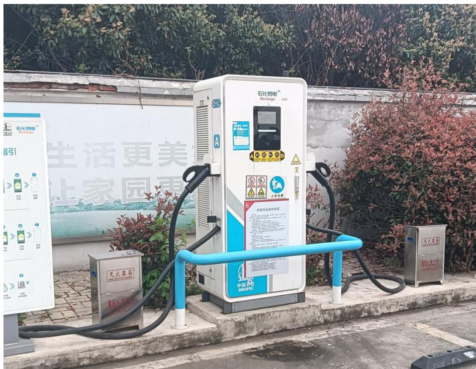
图 2-15 加油站充电桩照片
