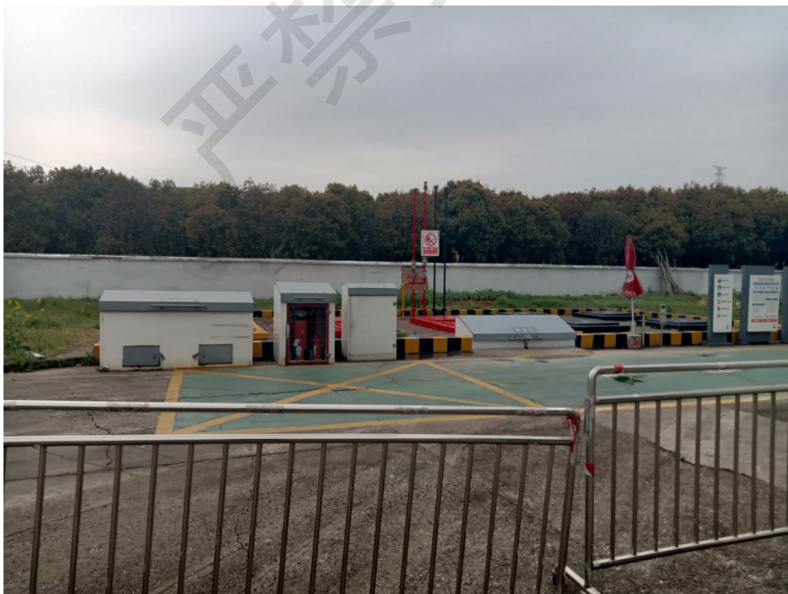
加油站罐区照片
