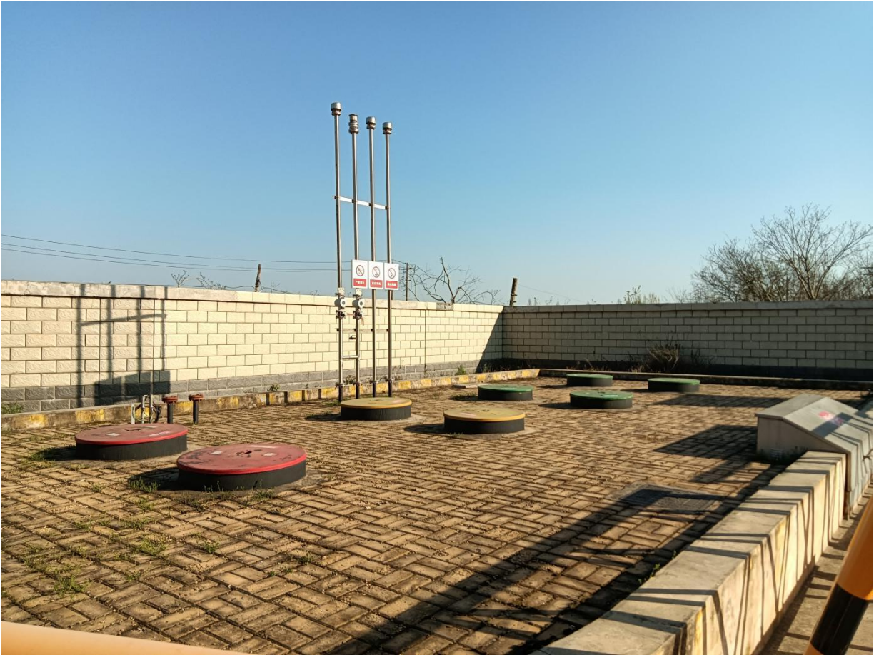
图 2-10 加油站罐区照片
