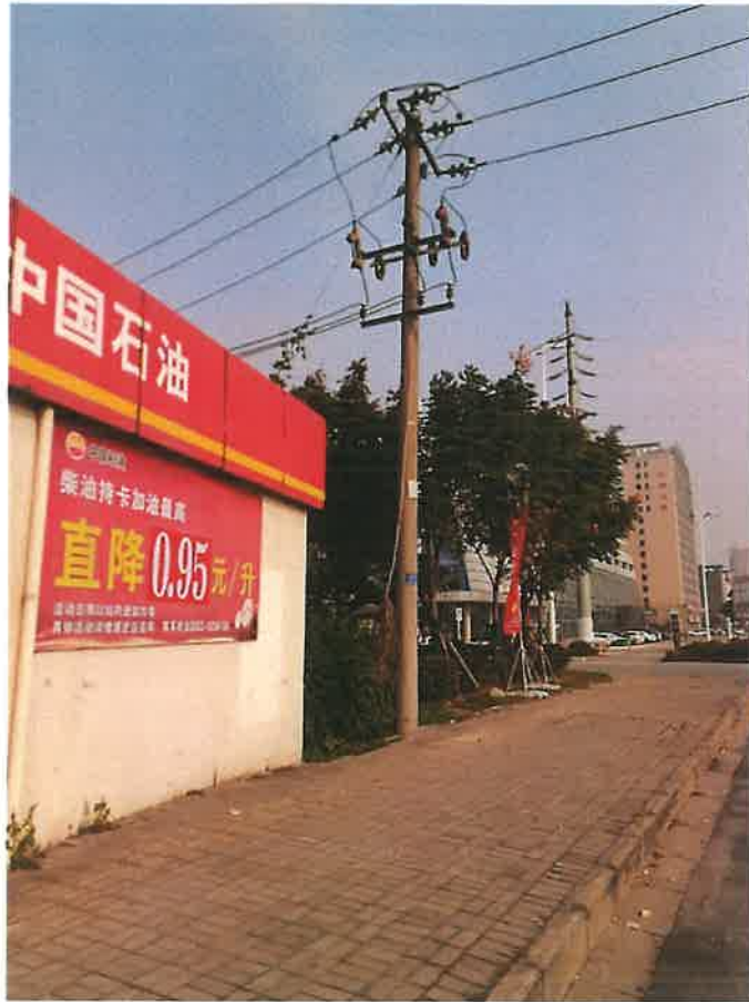
图6 项目东南侧杆高7m的架空电力线（有绝缘层）
