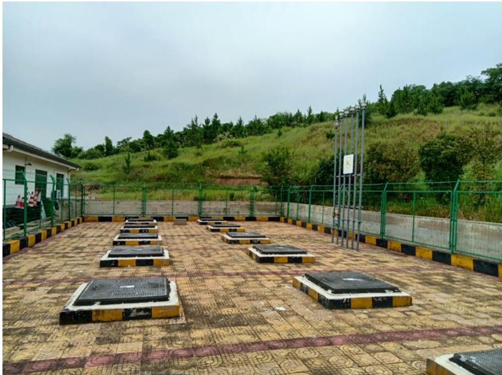
望江服务区加油站北站罐区照片
