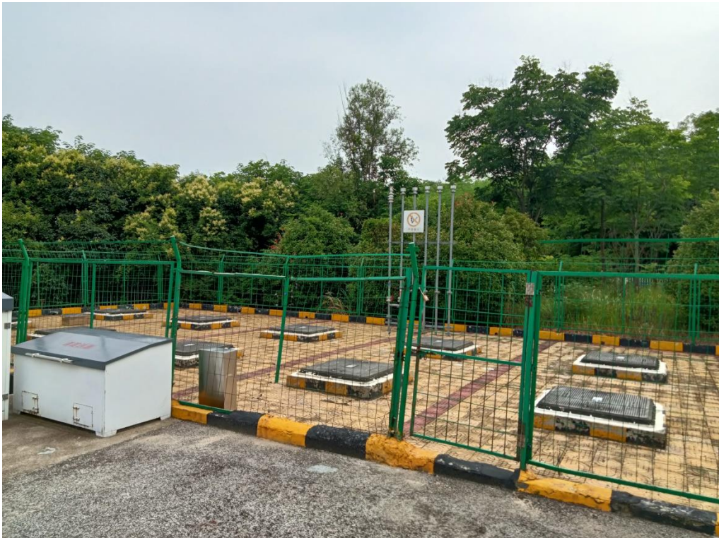
望江服务区加油站南站罐区照片
