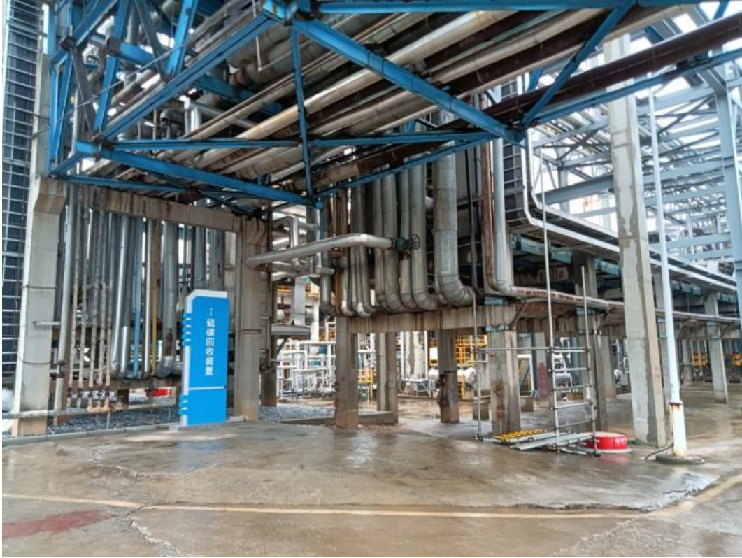
图 7 建北侧 4 万吨/年硫磺回收（I）装置
