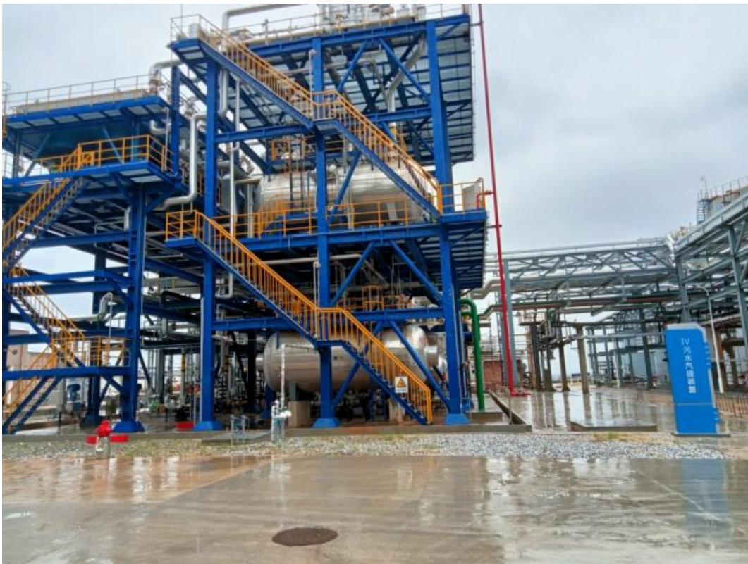
图 8 建西侧IV污水汽提装置
