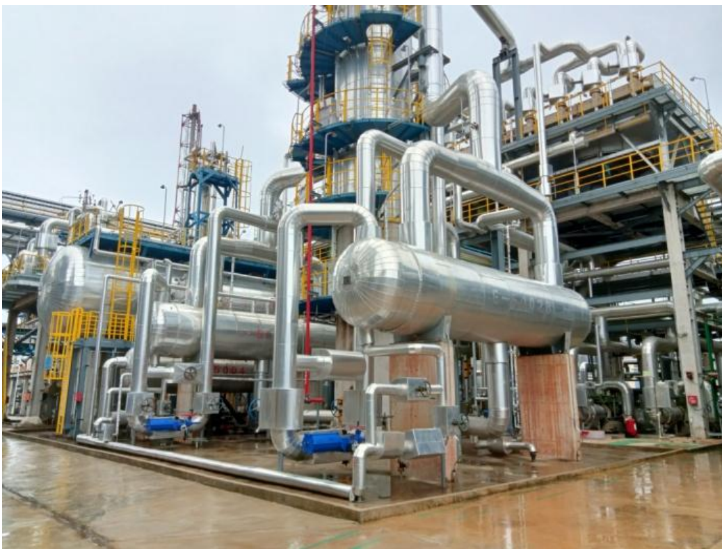
图 2 新建溶剂再生（Ⅴ）装置
