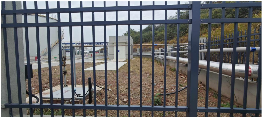
(8) 管道终点: 亚科科技厂区物流门北侧界区围墙内氢气管线阀组处
