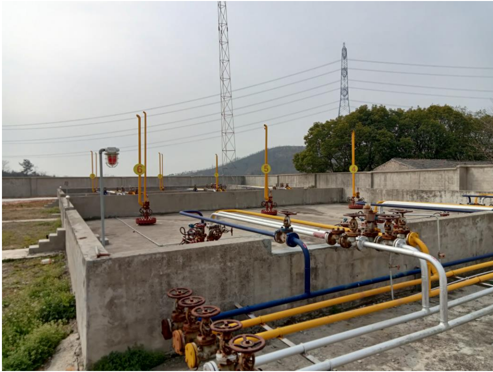
液化石油气储罐区照片
