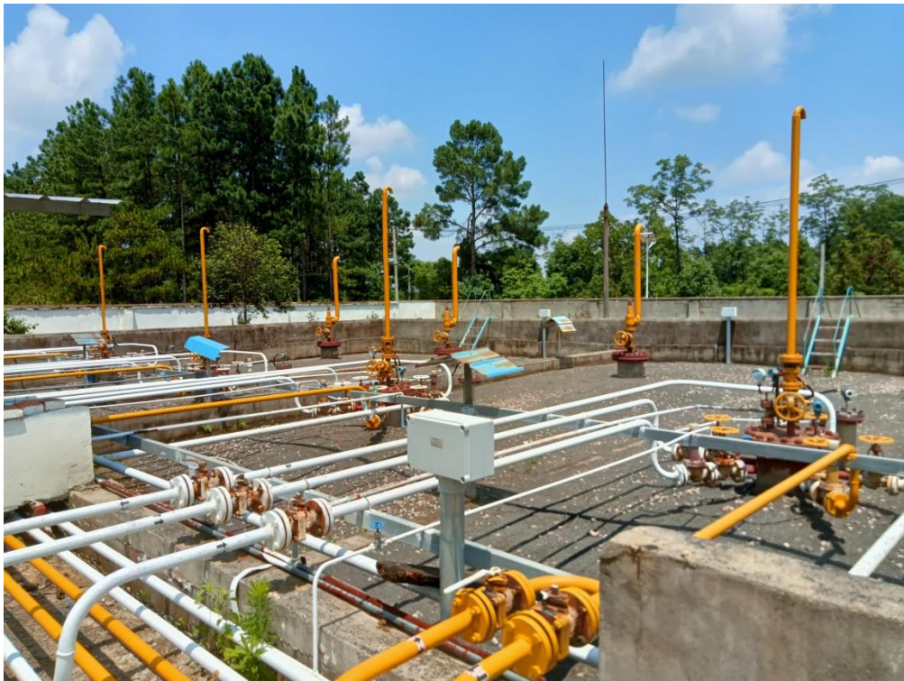
液化石油气储罐区照片
