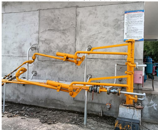
图 9 庐江县龙山液化气站卸车柱
