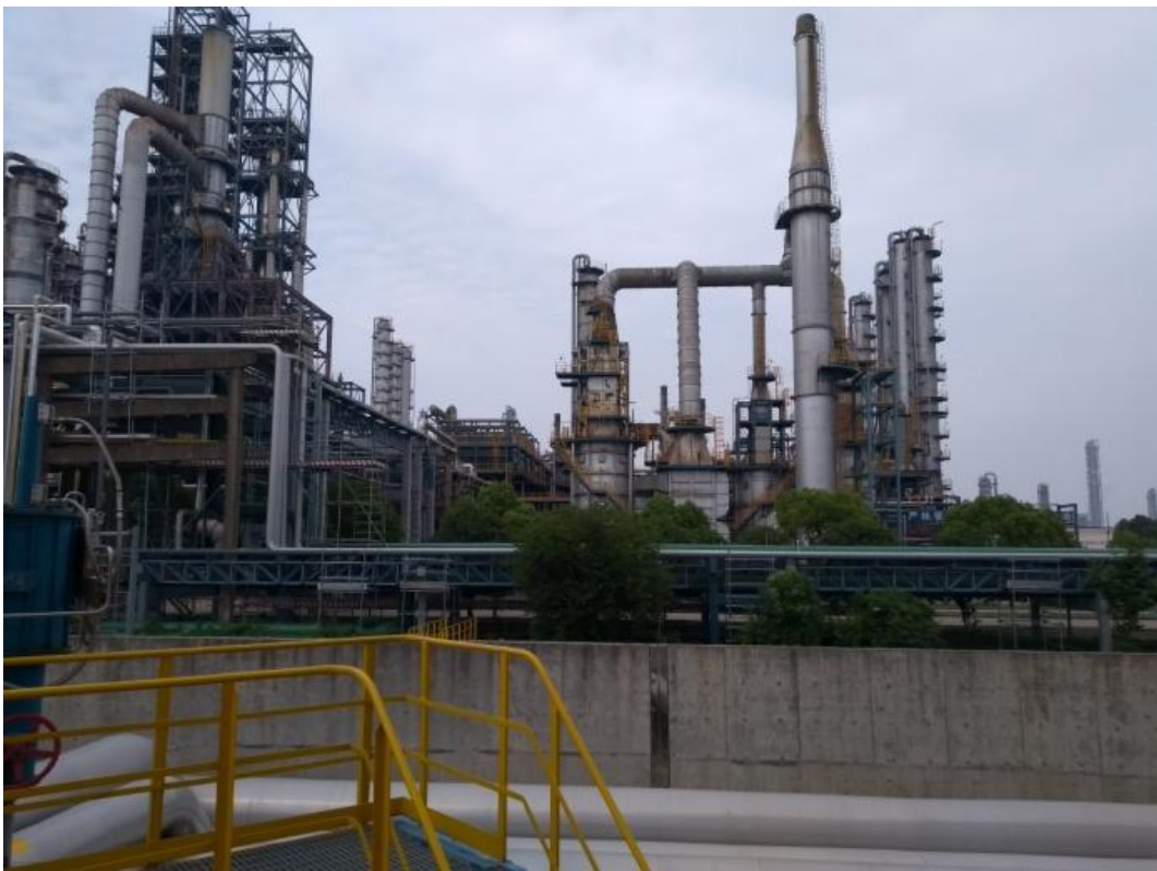
图 20 9#原油罐组、配电室及泡沫站建东侧连续重整装置和芳烃抽提装置
