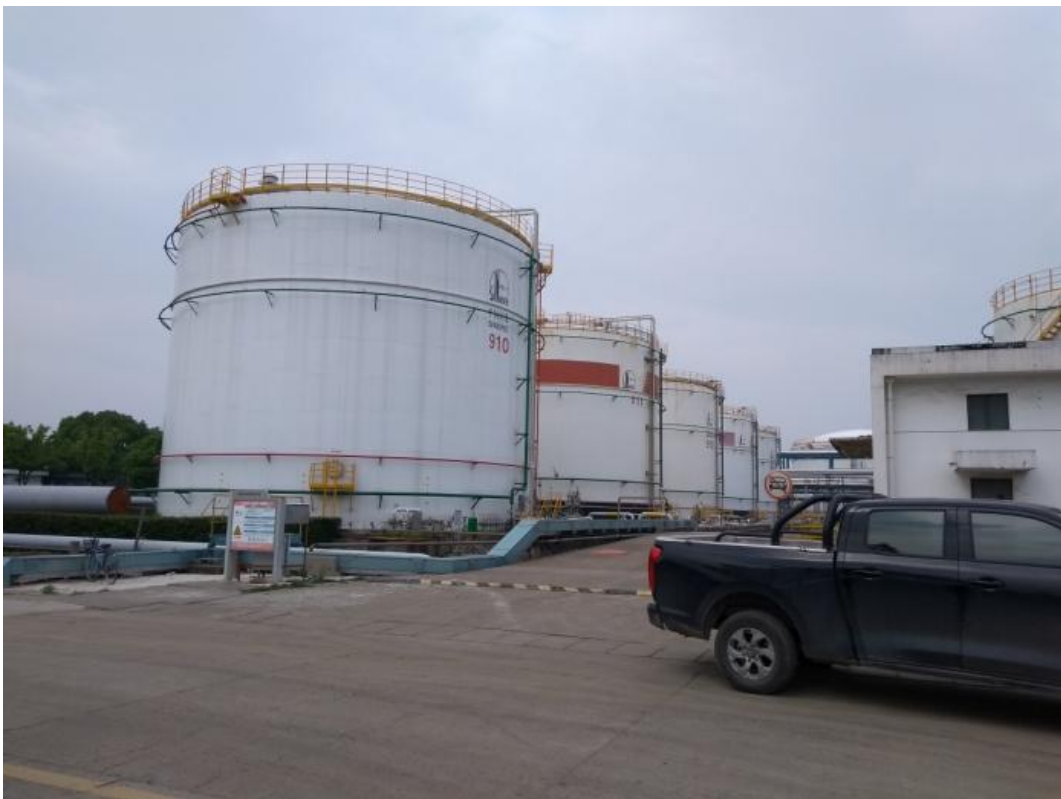
图 8 甬绍金衢首站罐组建东侧芳烃罐区
