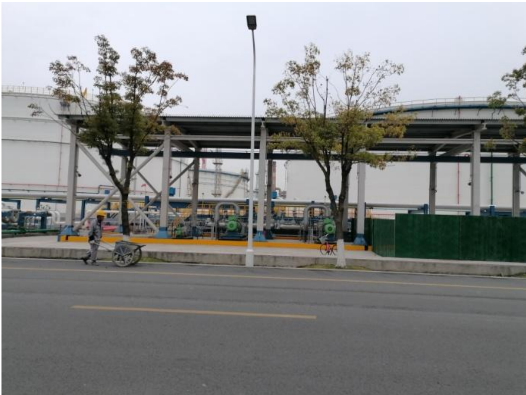
图 14 甬绍金衢首站建西侧倒罐泵棚
