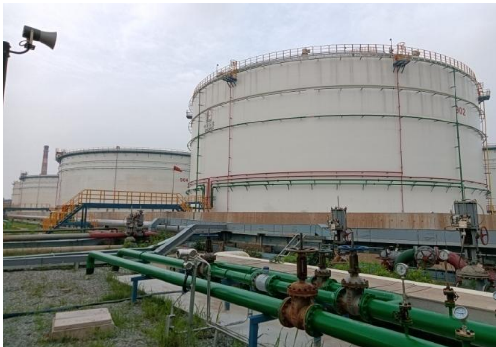
图 1 甬绍金衢首站罐组
