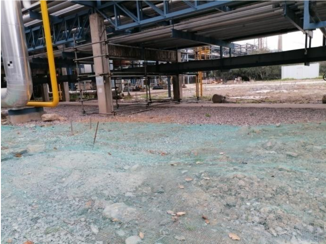
图 19 区域变配电所及机柜间建北侧凝缩油泵区
