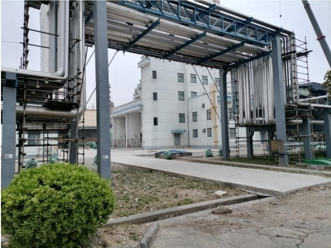
图 7 甬绍金衢首站罐组建东侧炼油三循
