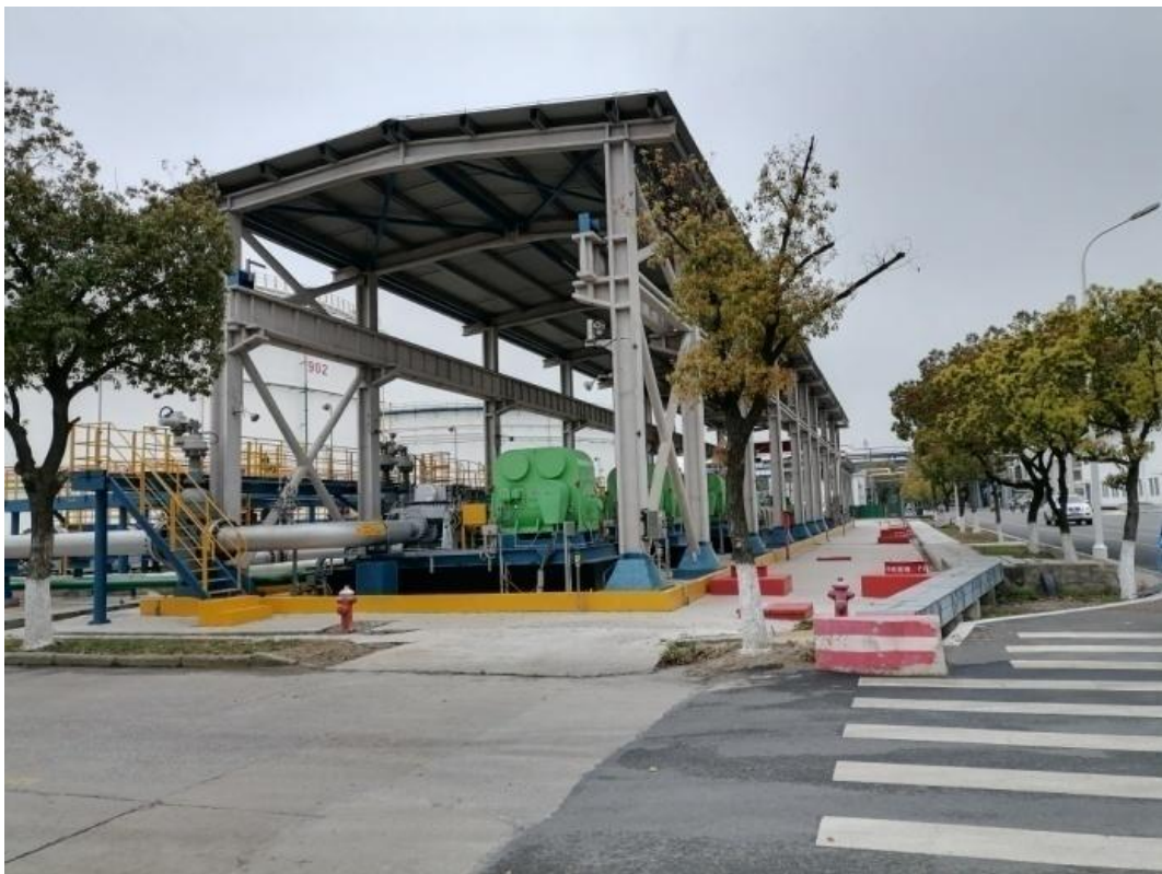
图 10 甬绍金衢首站罐组建北侧甬绍金衢首站泵棚
