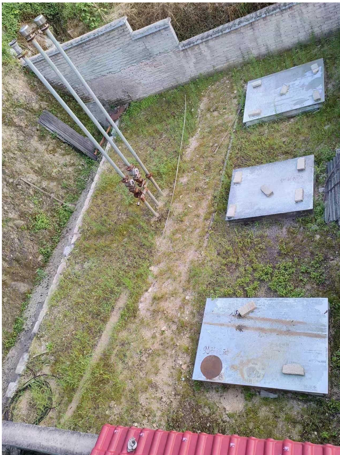
华恒加油站罐区照片
