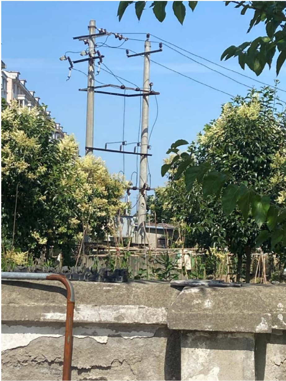
站区东侧：变压器和小区
