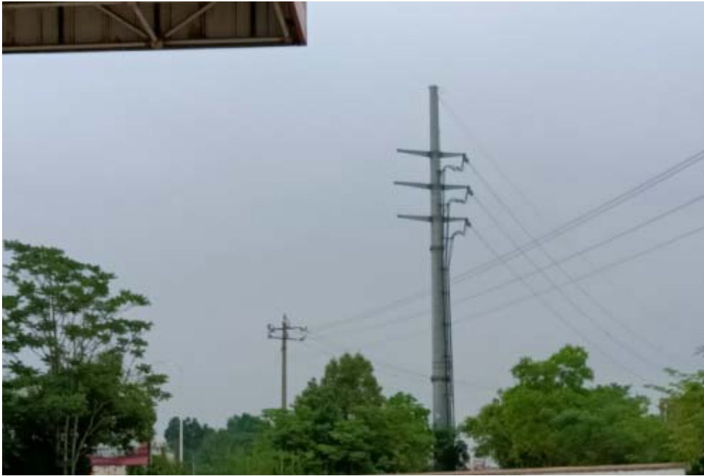
加油站东侧架空电力线路
