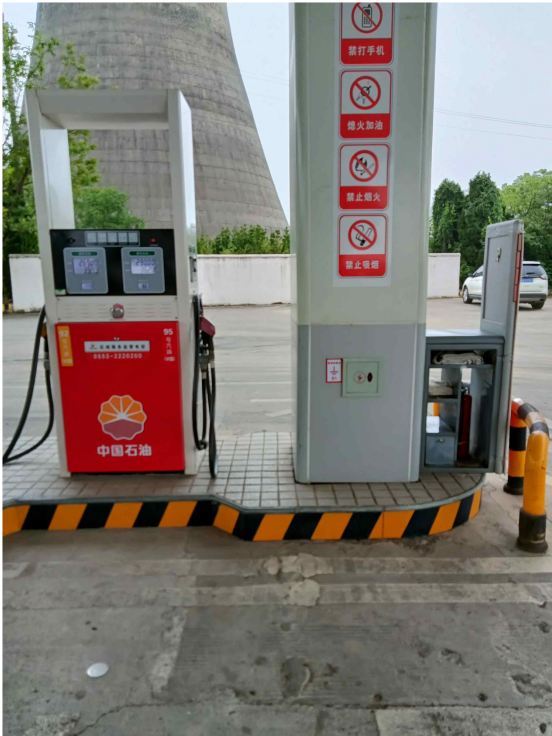
腾达加油站加油机照片
