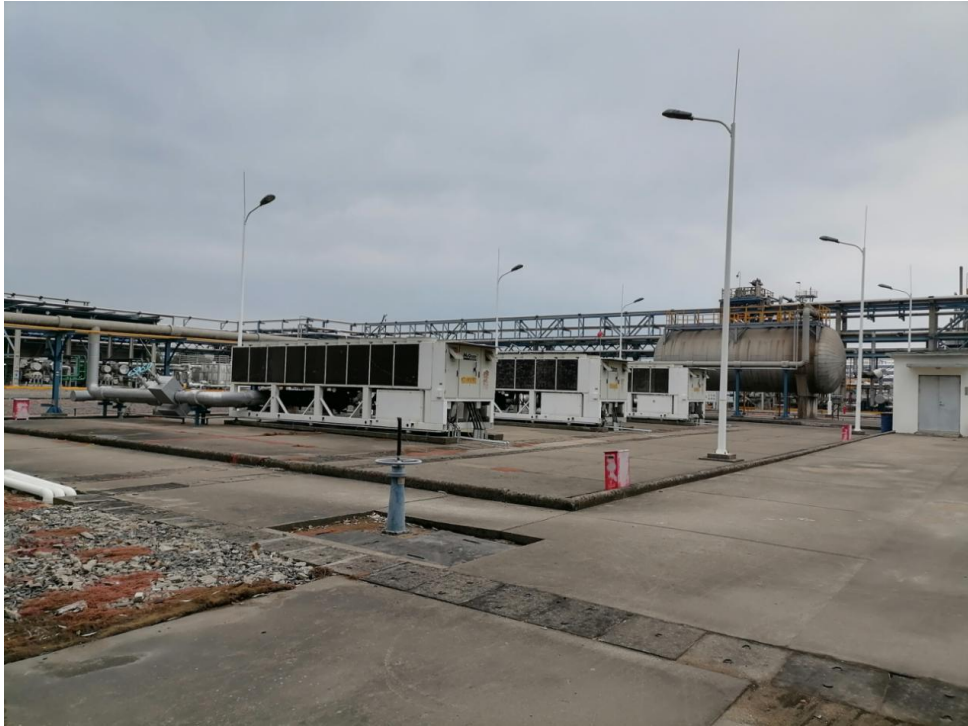
2#空分装置建西面为镇海炼化环氧乙烷（EO）装车设施、变配电室、机柜间、冷冻站、液化烃储罐区
